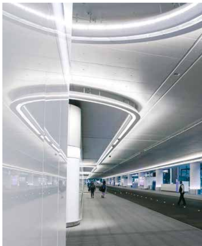
Abb.: Über das Ankunftsareal verteilen sich 22 Säulen. In der Sockelverkleidung sind Uplights von LMT mit RGB-LEDs integriert. (Foto: Fraport AG)
